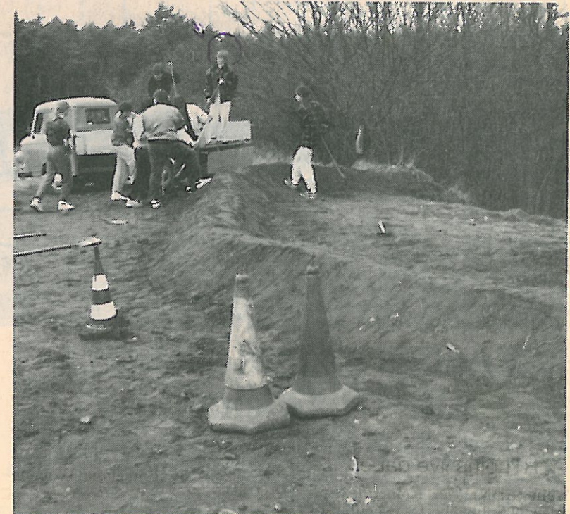
Viel persönliche Freizeit und Engagement haben die Jugendlichen bis zum jetzigen Zeitpunkt in die Wiederherrichtung der Strecke investiert. Foto: dw.
